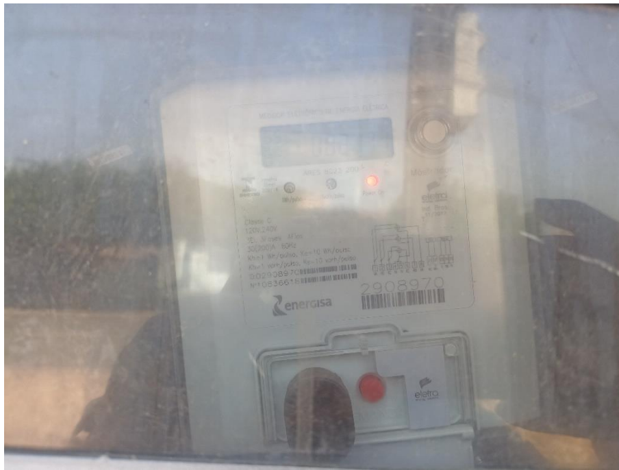
Foto 14. Prédio para Locação em Alta Floresta – Vista do relógio do padrão de energia da edificação. Foto em 15/11/2023.
