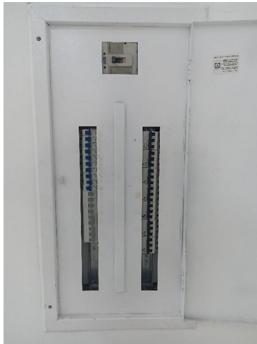
Foto 13. Prédio para Locação em Alta Floresta – Vista do quadro de distribuição elétrica da edificação. Foto em 15/11/2023.
