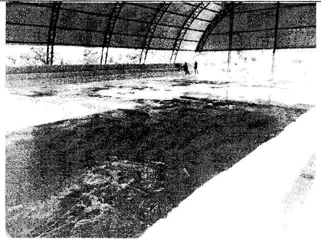
Foto 10- Pintura da quadra não corresponde ao especificado em planilha – a pintura em execução é do tipo epóxi.
